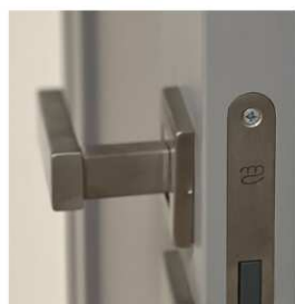
WIDOCZNY BRAK FELCA
